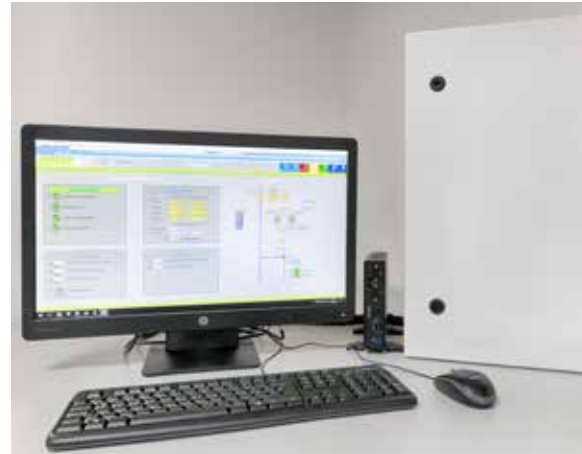
Abb. 38: E-CONTROL mit Bildschirmanzeige Heizhaus
