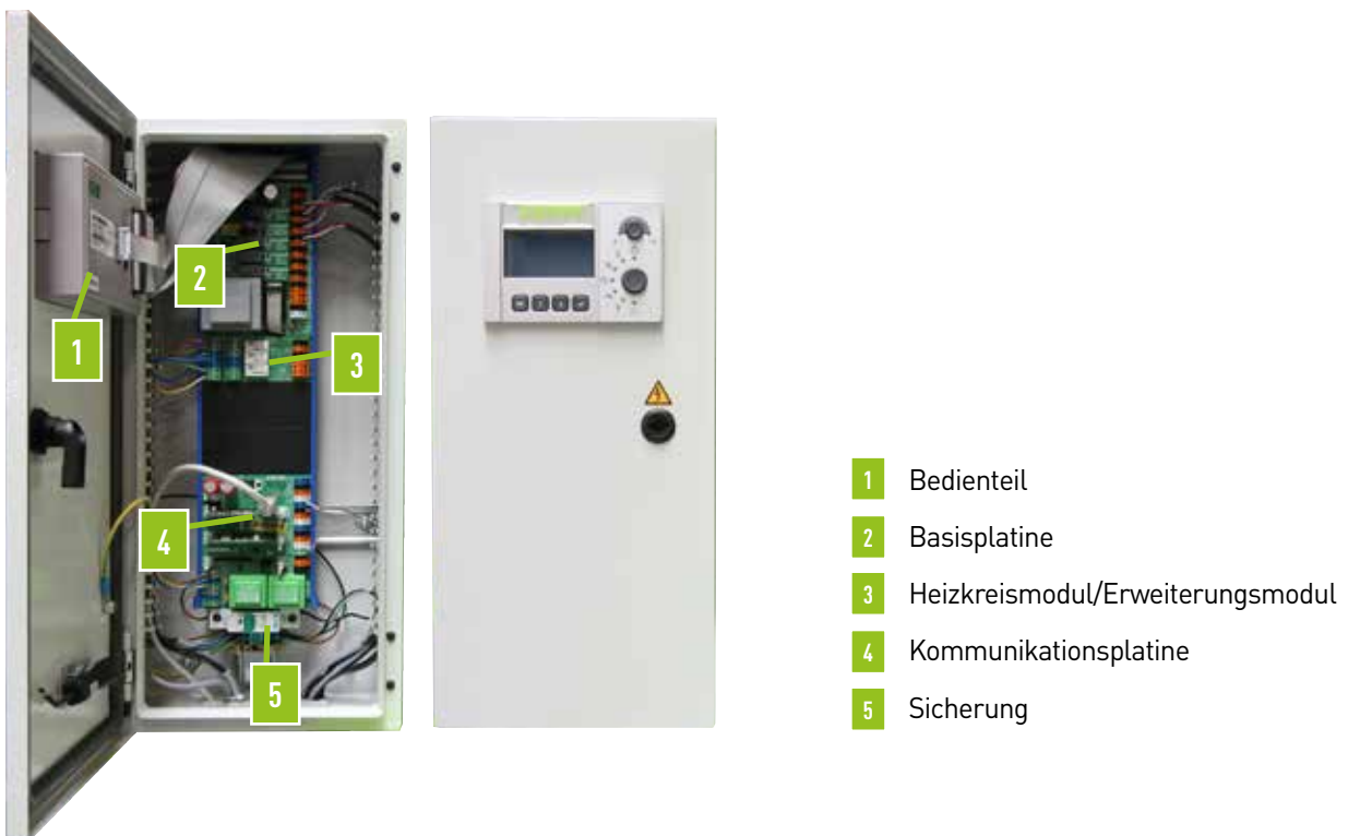
Abb. 23: Schaltschrank für die Übergabetechnik
