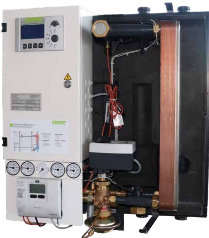
Übergabestation ohne Verkleidung
