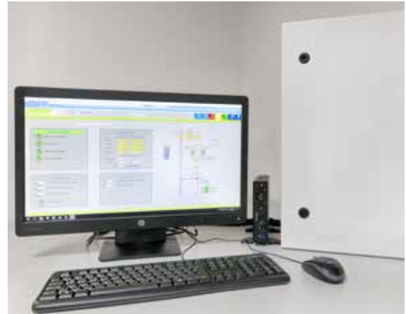
Abb. 38: E-CONTROL mit Bildschirmanzeige Heizhaus
